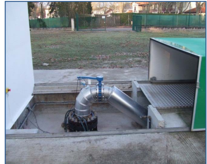
Tête de puits du forage géothermique GMM-1
