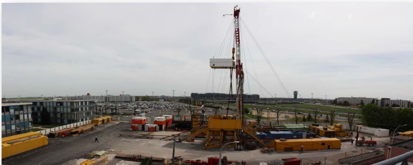
Aéroports de Paris a obtenu la certification ISO 50001 grâce à la géothermie
