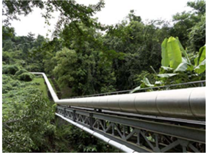
CFG Services se consacre essentiellement à la géothermie profonde, comme ici à Bouillante
